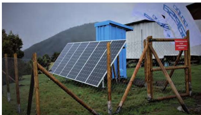
Panel Fotovoltaico inaugurado en septiembre 2018, sector Puquintrin, proyecto Pilfuco
