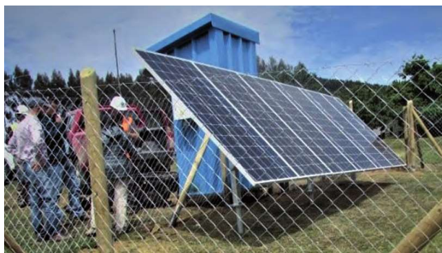
Panel fotovoltaico permite energía gratuita a los habitantes
